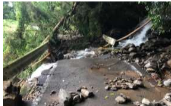
山間部の至る所で道路崩壊が。 今回の豪雨は洪水被害ばかりでは なく、山間部の地形や水流、川の 流れさえ大きく変えた。
